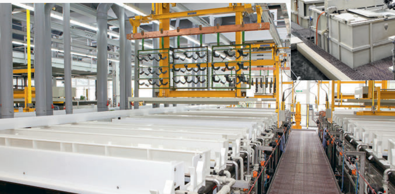
Galvanoautomat für Gestellartikel Automatic electroplating plant for rack items
